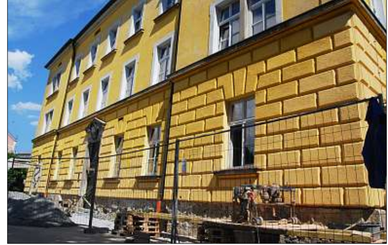
Der komplette Sockelbereich des Amtsgerichts ist derzeit freigelegt – und auf etwa einem Meter Höhe wird das Gebäude rundherum durchgesägt.
